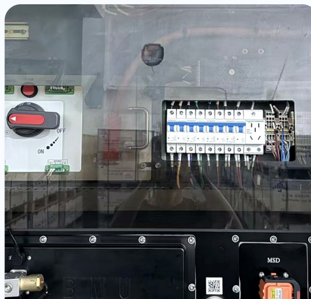
02 · BMS / BMU & HV Battery Control
